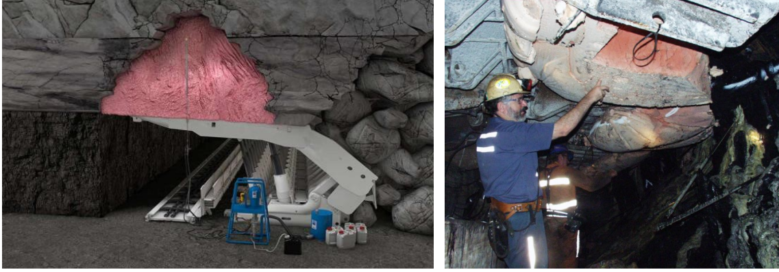
Şekil 1: Ayak içi yürüyen tahkimat üzeri boşlukların köpük ile doldurulması (Weber Kataloğu, 2019; Frith, 2006)
