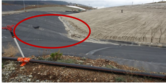
Şekil 14. Filtrelenmiş atık depolama alanından su boşaltımı için kullanılan borular
